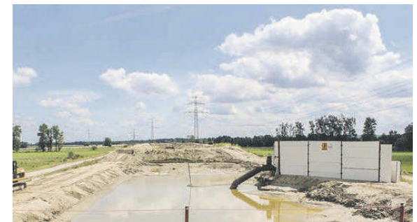
Hier kommt der Sand aus Ovelgönne an. Damit wird der bis zu zwölf Meter hohe Vorbelastungsdamm gebaut
